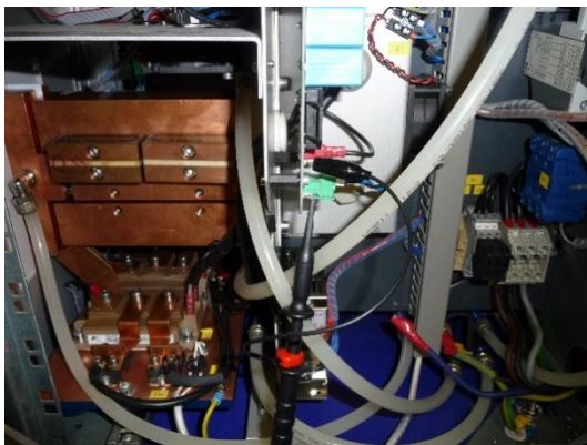
Abbildung 35: TNX5-30: In der Mitte der Backbordseite des Generators.
