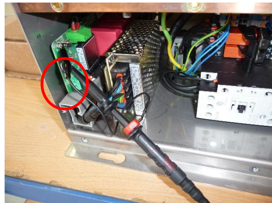
Abbildung 26: Compact, auf der Versorgungsseite, finden Sie die C-Bar mit den Prüfstiften auf der linken Generatorseite.
