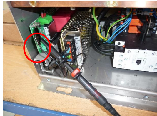
Abbildung 26: Compact, auf der Versorgungsseite, finden Sie die C-Bar mit den Prüfstiften auf der linken Generatorseite.
